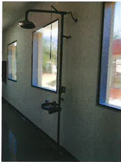
Ducha de emergencia y lavaojos
