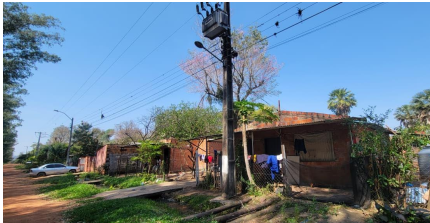
Figura 3: Puesto de distribución, con línea abierta y conductores desnudos.
